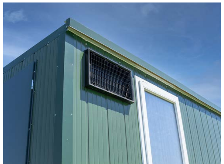
Élément de ventilation
